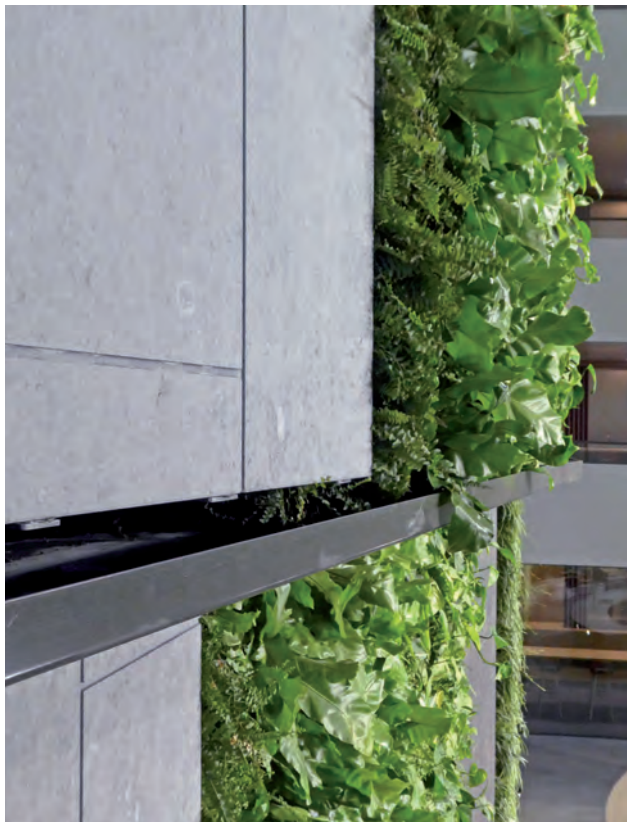
European Medicines Agency Amsterdam. Ontwerp RVB, MVSA Architects, OKRA landschapsarchitecten. Onder de groensegmenten zijn rvs-goten aangebracht om het overtollige water af te vangen. Foto Josine Crone.
